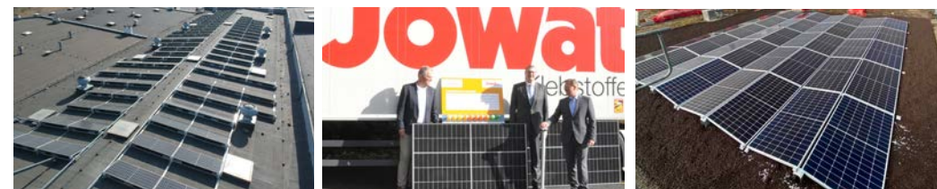
Wir setzen auf erneuerbare Energien, z.B. durch Solardächer wie hier in Polen, Malaysia, Schweiz und Detmold
